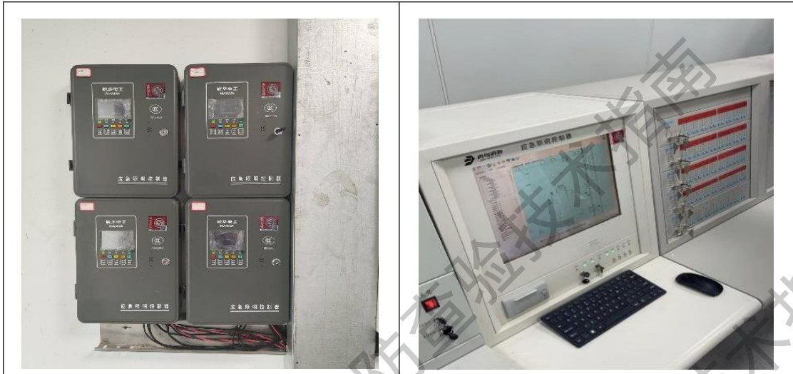
应急照明集中电源设置在配电间内，且采用下出口进出线方式
