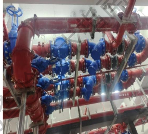
减压阀进口处设置过滤器
