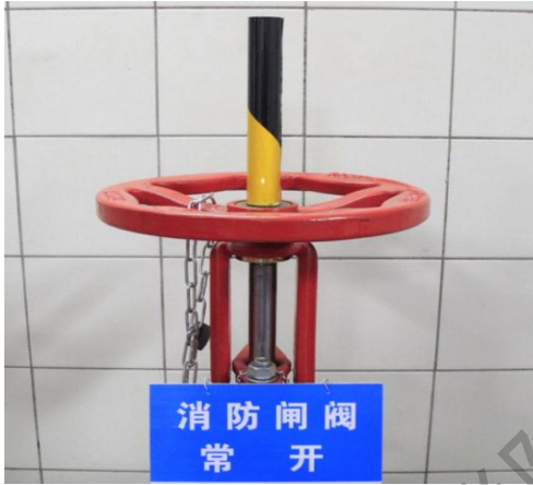
明杆闸阀处开启标识
